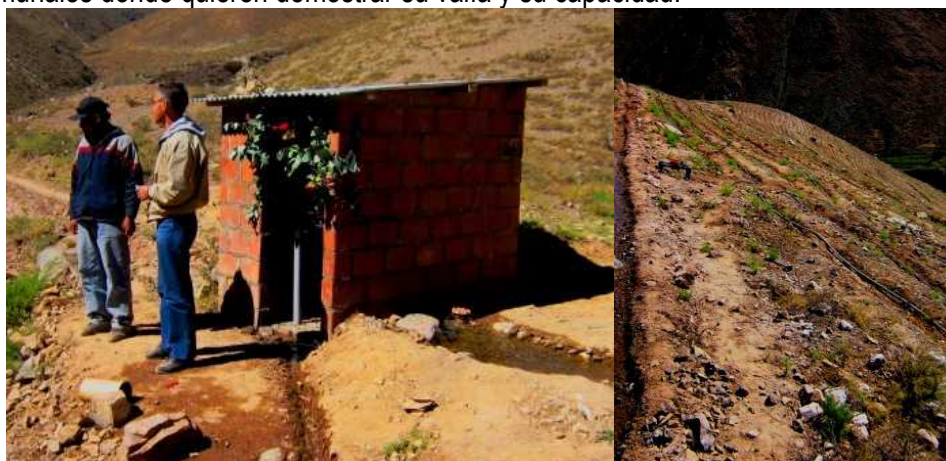
La caseta para el riego y la primera zona con mangueras
